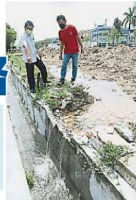
余保瓚 (左) 與吳永源促請雪州水務管理公司盡快解決水閘閘漏水的問題，以免浪費更多的淨水。
