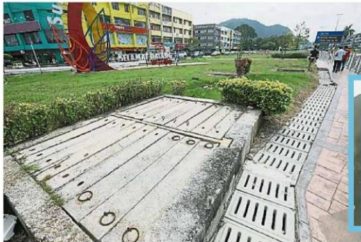
斯里士拉央花園商業區大路旁的水閘閘出現漏水問題長達3年，遲遲沒有獲得解決。
