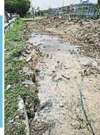
水閘閘漏水問題造成附近路面都是积水。
